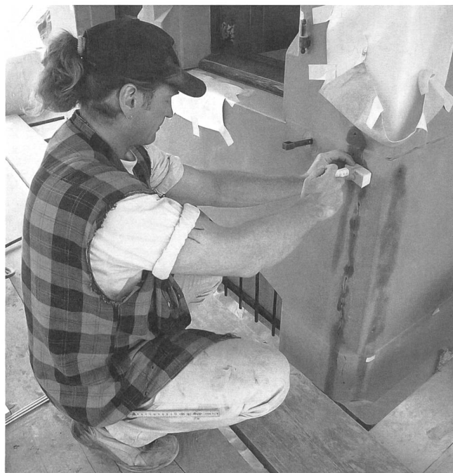
Mitarbeiter der Münsterbauhütte greifen für die Sanierung des Sandsteins am Torturm zur Injektionsspritze.
