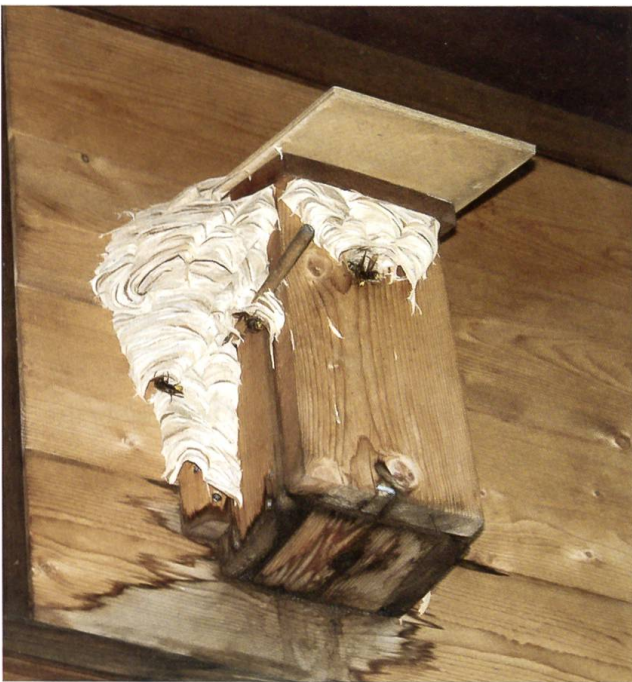
Hornissennest in einem Vogelnistkasten, dessen Wände die isolierende Hülle grösstenteils ersetzen
