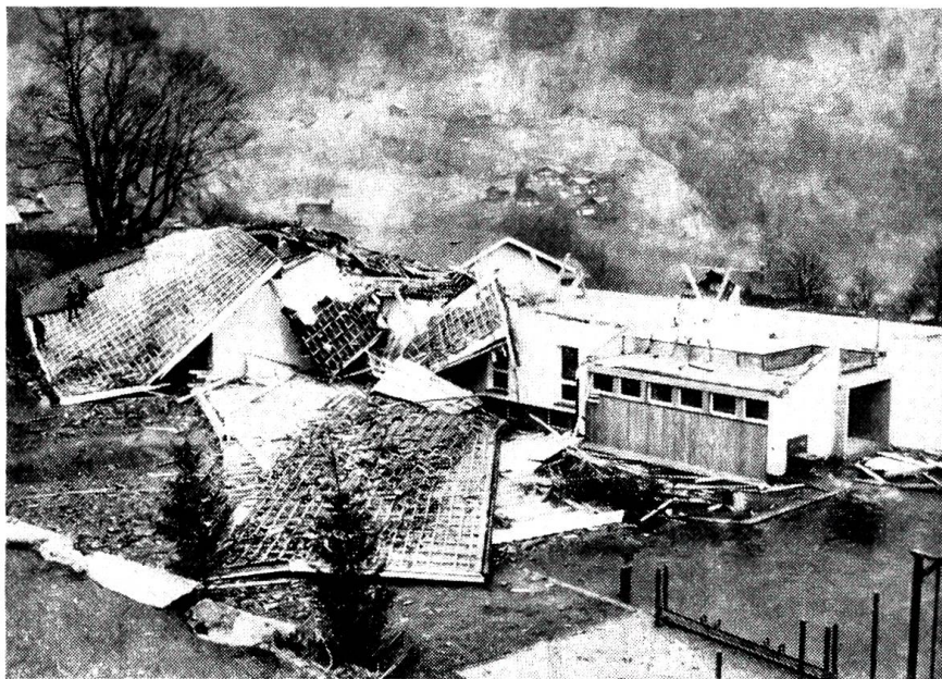
Der Föhnsturm vom 7. November 1962 wütete namentlich im Berner Oberland wie kaum je ein anderer zuvor. Ganze Wälder fielen dem Orkan zum Opfer, und viele Häuser wurden in Mitleidenschaft gezogen. Unser Bild zeigt das neu erbaute Schulhaus von Grindelwald, dessen ganzes Dach mitsamt dem Dachstuhl vom Wind weggetragen wurde.
