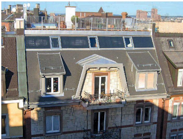
Sorgfältig ins Dach eingefügte Solaranlage zur Warmwasseraufbereitung in Zürich (Bild Stadt Zürich)
