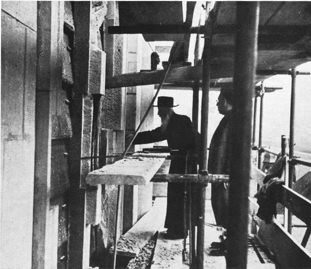
An der Westfassade der Stiftskirche Einsiedeln (1719–1726). Schallfenster am obersten Geschoß des Nordturmes (1949). An Gewände und Mittelpfosten sind die verwitterten Teile abgetragen; der Ersatz besteht überwiegend in zu dünnen Vorblendungen (siehe Text S. 82).
