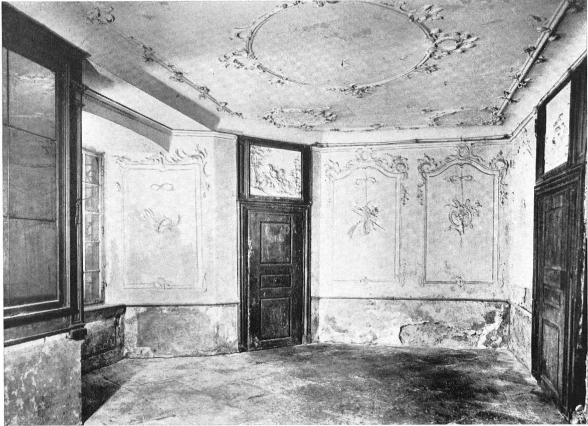
Schloß Bottmingen. In traurigem Zustand befand sich vor allem der Gartensaal mit seinen zierlichen Stukkaturen.
