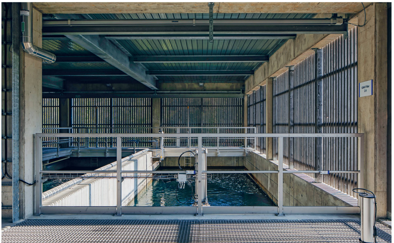
Die vierte Klärstufe zur Elimination von Mikroverunreinigungen (EMV) des Abwasserverbands Altenrhein AVA La quatrième étape de traitement des eaux usées pour l'élimination des micropolluants de l'association pour l'épuration des eaux usées d'Altenrhein.
