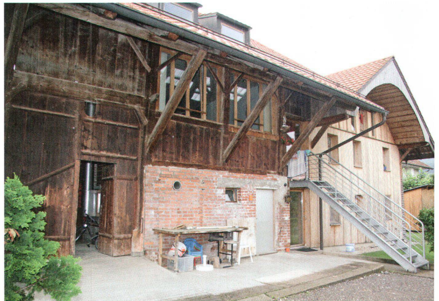
Der Eigentümer entschied sich von Anfang an gegen das künstlich Alte und liess in der Scheune moderne und funktionale Wohnungen einbauen (Bild C. Crausaz)
