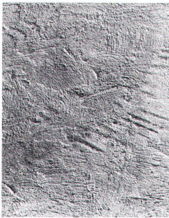
Crépi à la chaux portant à l'évidence la «signature» du maçon (photo Baertschi).
