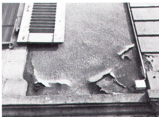
Sur ce vieux mur, le crépi au ciment n'a manifestement pas fait ses preuves (photo Baertschi).
