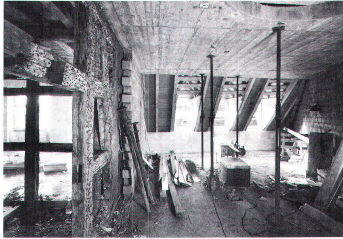
Starre Betondecken in Altbauten sind artfremd und wirken optisch steril (Bild Hochbauamt Stadt Basel)
