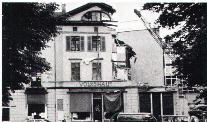
Cet édifice eût pu être sauvé pour 3 fr.: quand l'intention du propriétaire de le démolir fut connue, un recours fut déposé. Avec succès! Mais l'interdiction arriva trois heures trop tard, parce que non expédiée par exprès...
