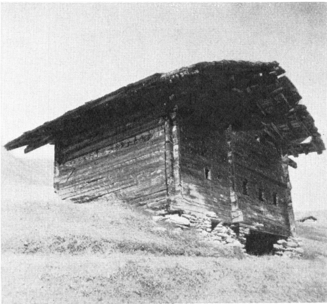
Un chalet Walser de trois étages, dans l'Avers, inoccupé, dégradé.
