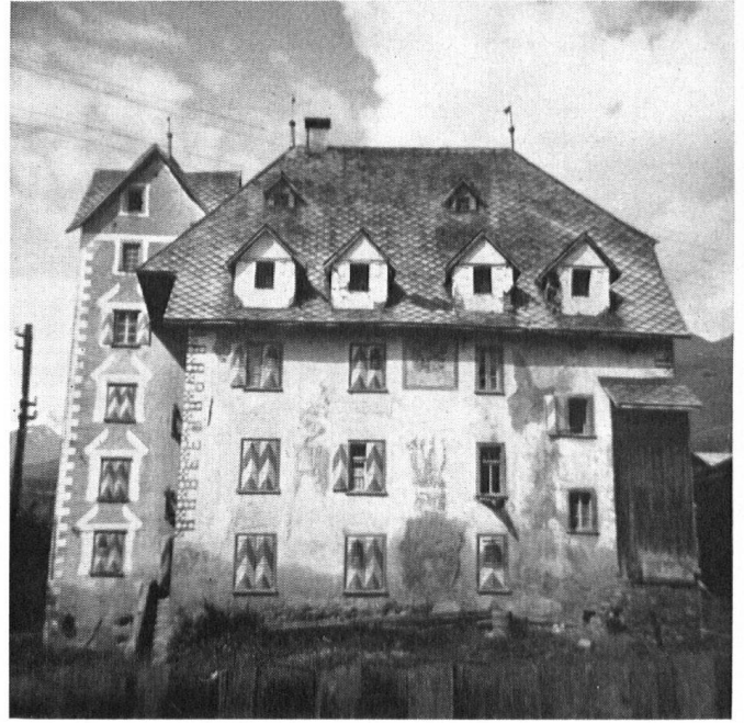
Das Schloß de Mont in Vella (Lumnezia). Dieses Wahrzeichen von Vella, den Dorfplatz abschließend, bedarf dringlich der Erneuerung. Man beachte den Zustand der Dachfenster. Im Jahre 1666 erbaut, gehörte es der Familie de Mont-Schauenstein. Das reiche Getäfer wurde ins Landesmuseum überführt. Pater Notker Curti OSB pflegte zu sagen: «Wenn ein Bauer ein Herrenhaus übernimmt, macht er es kaputt, oder es macht ihn kaputt...!»
