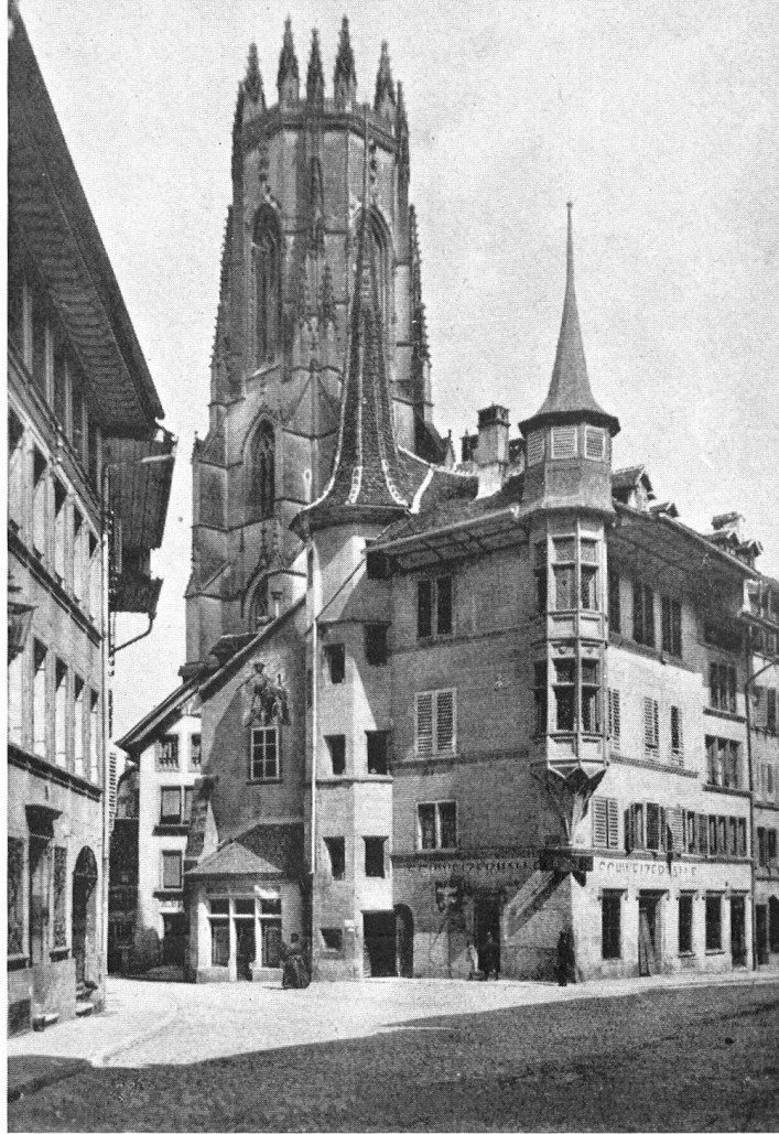
Eine Instandstellung in Fribourg: Das im Jahre 1611 erbaute Haus »Les Tornalettes« mit seinem zweigeschossigen Erker und achteckigen Treppenturm. Dem Zerfall nahe war vor allem der spätgotische Erker.
