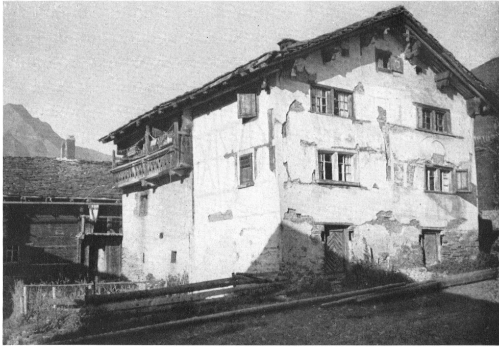
Vrin. Übertünchtes Riegelhaus. Schöne Verhältnisse, doch der bedenkliche Bauzustand läßt ahnen, daß der Eigentümer nicht wohl bestellt ist.
