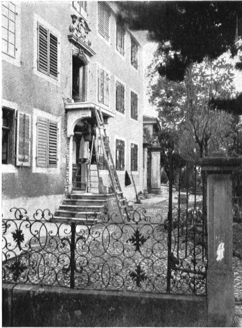
Die Strassenfassade. Der alte Balkon samt Balkontüre und Hauptportal ist ins Ausland verkauft. Das Bild zeigt wie ein neuer Balkon für den zum Verkauf herausgebrochenen eingesetzt wird. Façade de la rue. L'ancien balcon, sa porte et le portail principal ont été vendus à l'étranger. Notre photographie montre comment on travaille à remplacer le balcon vendu
