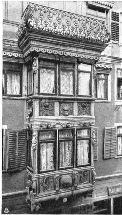
ERKER AM HAUSE „ZUR KUGEL“, durch den auf- gesetzten Balkon mit gusseisernem Geländer entstellt FENÊTRE EN SAILLIE à la maison de „la boule“, enlaidie par un balcon en fonte
