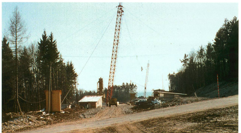
Für den Bau der Teufelsbrücke wurde ein Kippmasten-Kabelkran mit einer Spannweite von beinahe 250 Metern eingesetzt. Auch bei der Teufengrabenbrücke kam ein solcher Kran zum Einsatz.
