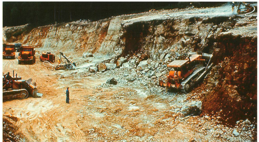
Die unterschiedliche Beschaffenheit der steilen Böschungen macht Probleme.
