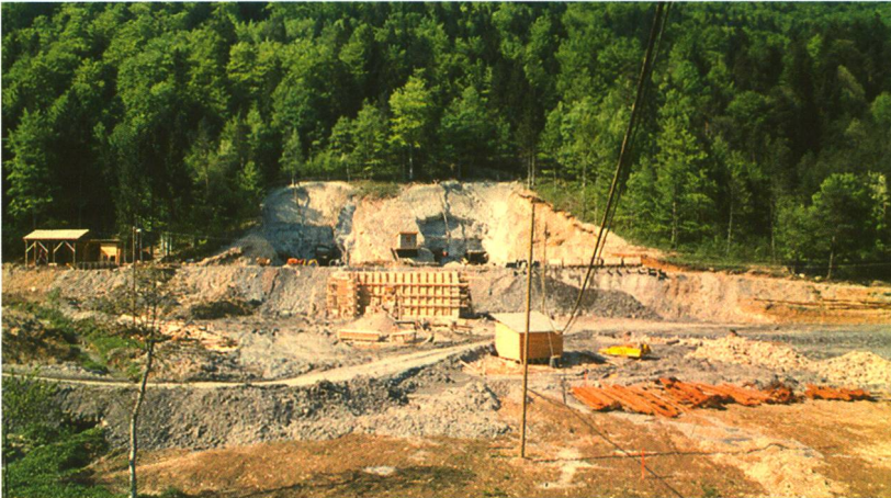
Die Tunnelbaustelle von Süden. Eine kleine Bahn (rechts des Tunnel- portals) transportiert das beim Vortrieb der Sohlstollen anfallende Ausbruch- material aus dem Berg. Im Lokdepot (links) wurden die Zugmaschinen gewar- tet und deren Batterien aufgeladen.
