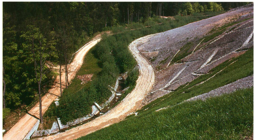
Der neue Bachlauf ist bereits begrünt. Vor der Bepflanzung der steilen Deponieränder musste eine Drainage eingebaut werden.
