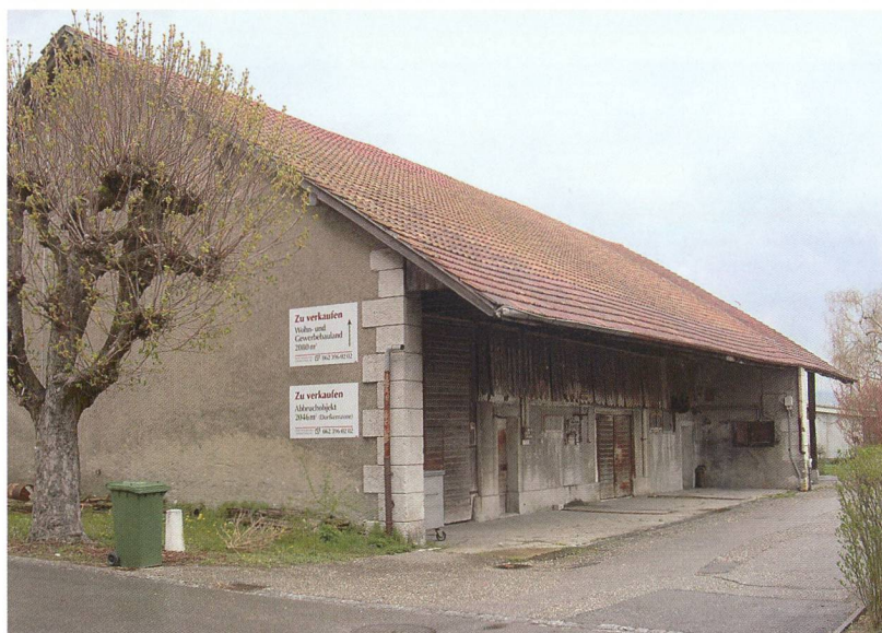
Das allein stehende Oekonomiegebäude an der Bachstrasse 26 ist im März 2006 dem Abbruchhammer zum Opfer gefallen. Die grosse Scheune war 1875 zusammen mit dem Restaurant Eisenbahn erbaut worden. 1
