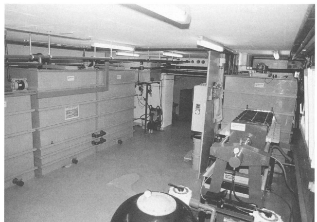
Computergesteuerte Abwasserreinigungs-Chargenanlage mit Filterpresse.
