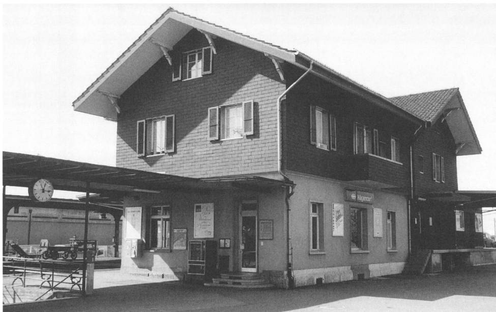
Abb. 8 Unter der Eternitverkleidung des Stationsgebäudes ver- birgt sich eine ...
