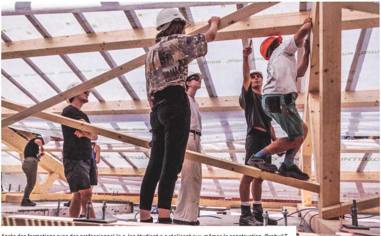
Après des formations avec des professionnel-le-s, les étudiant-e-s réalisent eux-mêmes la construction. ©rebuilT
