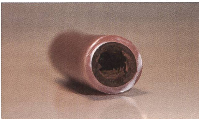
Conduite de chauffage au sol fragilisée et encrassée.
