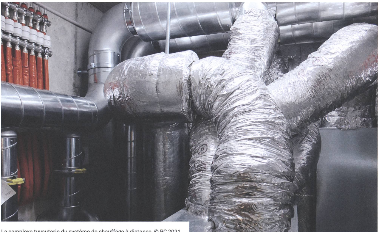
La complexe tuyauterie du système de chauffage à distance. © PC 2021
