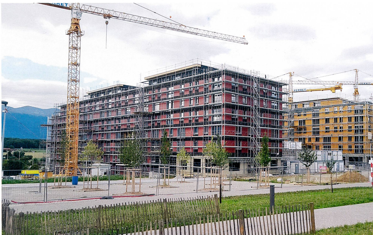
Les deux immeubles Codha-Voisinage et leurs attiques. Tout à gauche, après l'application du revêtement en fibro-ciment. Rouge de ce côté, gris-ivoire et jaune-champagne de l'autre. Bellmann/DR
