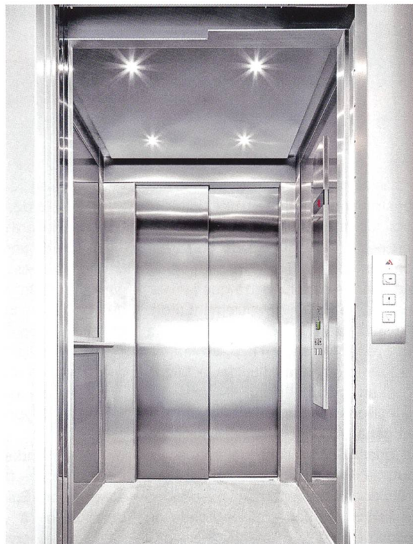
L'ascenseur permet aux fauteuils roulants d'accéder au nouveau service public.
