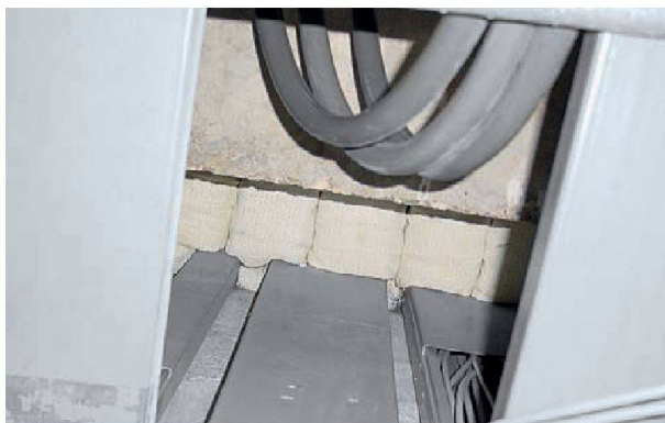
Interdit depuis 1990, l'amiante se trouve encore dans des immeubles construits avant 1990: ici, pour isoler la tuyauterie.
