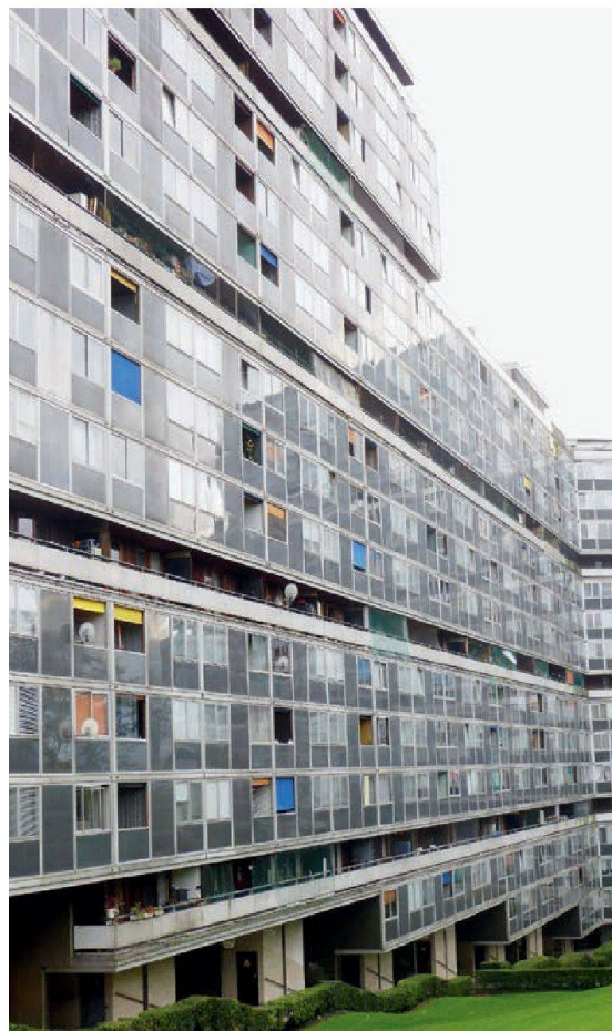
L'amélioration de l'isolation concerne essentiellement les façades-rideaux, vastes de 125 000 m 2 à l'échelle du site. © Borcard
