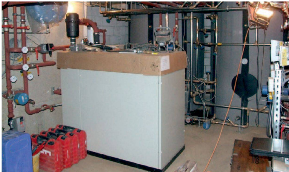
Vue de la salle technique avec au centre le bloc de cogénération. @ DOMO-Energie
