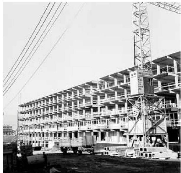
Atelier d'Architectes, immeuble pour la Société coopérative «Les Ailes» (1957- 1959) à Genève, photo de chantier
