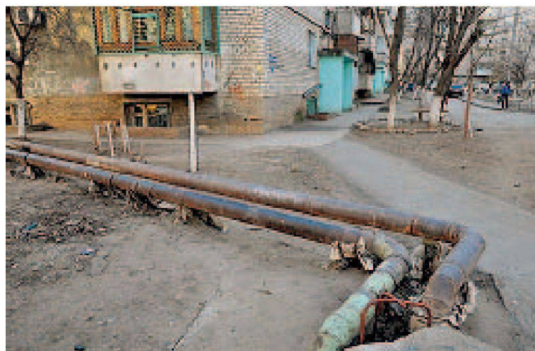
Bon nombre de conduites d'eau chaude agrémentent dangereusement le paysage urbain d'Astrakhan. © Ulrich Heyden
