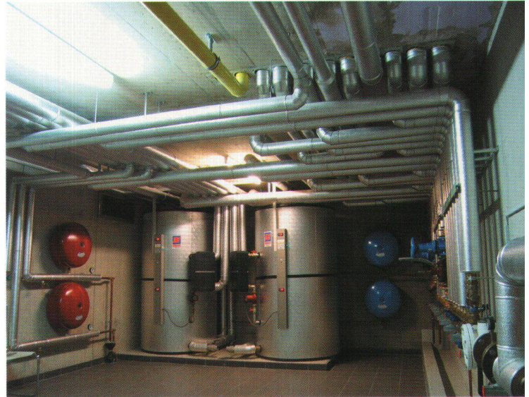
Vue générale des boilers d'eau chaude, des vases d'expansion et de la batterie de distribution avec départ en nappe.
