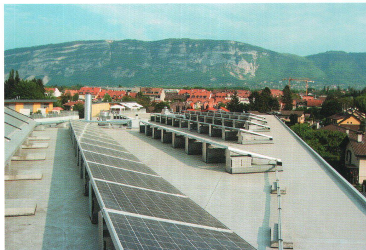
Les panneaux photovoltaïques installés sur la toiture. On devine à gauche les panneaux solaires thermiques qui assurent la totalité de la production d'eau chaude en ce mois d'avril 2007 très doux.
