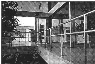
Vices de construction: balustrade intérieure inférieure à 100 cm, et ouvertures supérieures à 12 cm.
