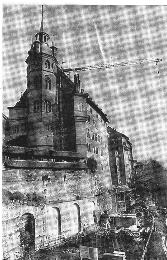
△ Hôtel de Ville de Fribourg Renforcement et réfection des murs des jardins Hertig.
