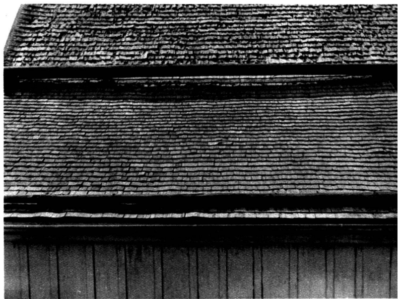
Utilisation des favillons sur toiture avec barres à neige. On remarquera la différence entre les favillons récents et anciens.
