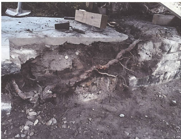
Abb. 3: Windisch-Amphitheater (V.024.80). Der freigelegte Wurzeleinwuchs hinter der äusseren heute aufgehenden Mauerschale und direkt unter der Mörtelabdeckung des beschädigten Abschnitts von Mauer 20.
