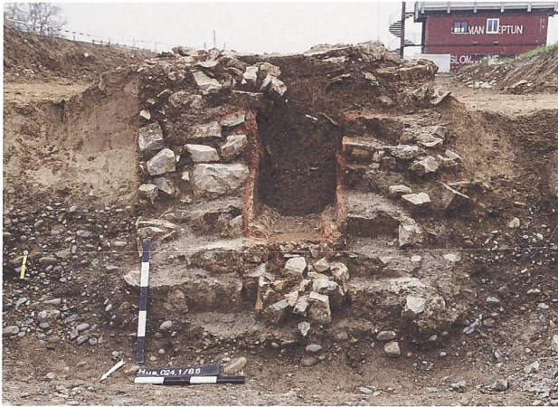
Abb. 33 Hausen-Reichholdareal 2024–2025 (Hus.024.1). Blick von Norden auf ein Profil durch die verschlammte römische Wasserleitung im Bereich einer neuzeitlichen Störung.
