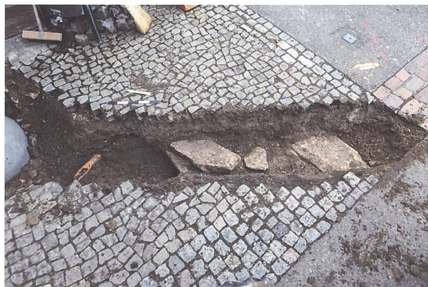
Abb. 31: Windisch-Lindhofstrasse 2024 (V.024.1). Blick von Westen auf den Werkleitungsgraben unmittelbar westlich des alten Feuerwehrmagazins mit gesetzten Steinplatten und Tonröhrenleitung (links).
