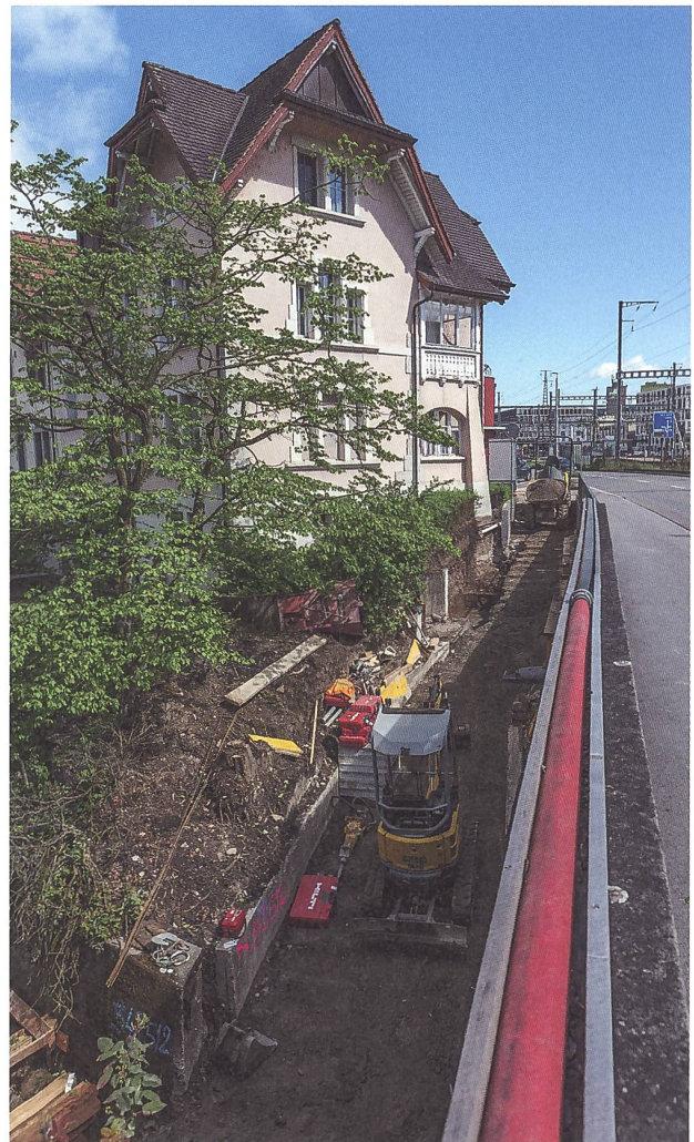
Abb. 30: Brugg-Süssbachunterführung 2024 (Bru.024.1). Arbeitsfoto von Südwesten auf die Bauarbeiten an der nördlichen Zufahrtsrampe. Aus dem Bereich zwischen Aarauerstrasse (rechts) und Bahnhof Brugg (Hintergrund) liegen ältere Fundmeldungen zu römischen Gräbern vor.
