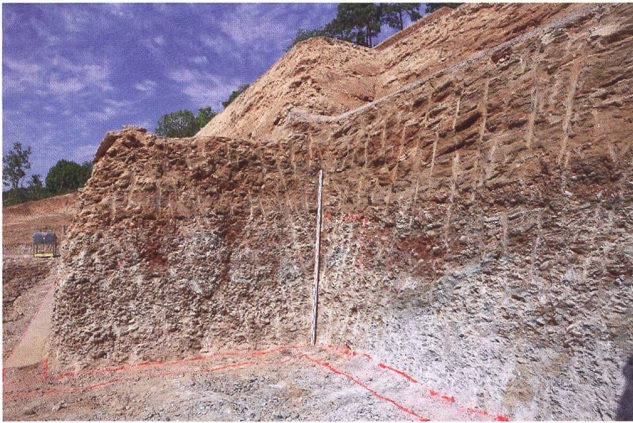
Abb. 26: Umiken-Chilhalden 2022 (Umi.022.1). Blick von Südosten auf den unteren Baugrubenbereich. Die 4 m hohe, mit dem Baggermeissel abgespitzte Profilwand zeigt die geologische Schichtabfolge mit hellbraunem Schwemmléhm, grünlichem Molassesandstein und Nagelfluh. Links oben markiert der Waldrand den Verlauf der historischen Bözbergstrasse.
