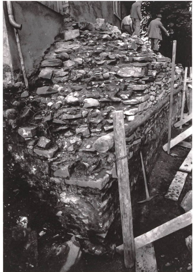
Abb. 2: Filzbach (GL) Vordemwald. Blick auf die Nordostecke des spätrepublikanischen/frühaugusteischen Wachturmes während der Sanierung im Jahre 1960.
