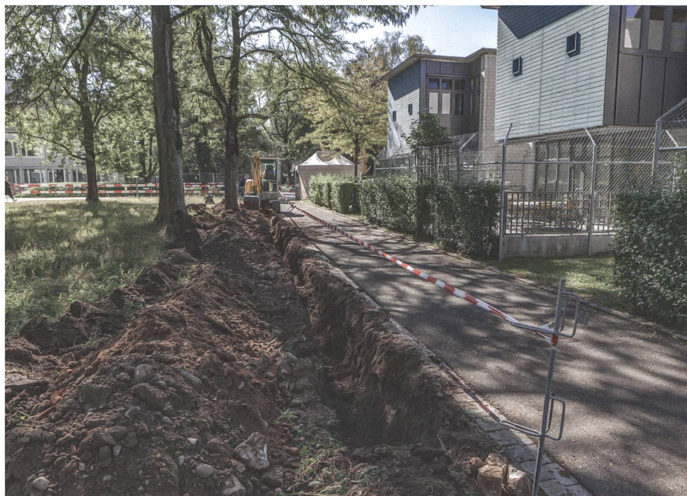
Abb. 9: Windisch-Königsfelden P4 (Kandelaber) 2020 (V.020.8). Blick von Norden auf den offenen Werkleitungsgaben westlich des Wohnheims «Sternbild» (rechts im Bild). Wo der heutige Asphaltweg der Klinik verläuft, lag in römischer Zeit eine gekieste Gasse zwischen zwei Nord-Süd orientierten Mannschaftsbaracken des steinernen Legionslagers.
