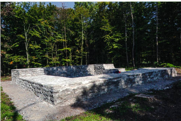
Abb. 1: Rheinfelden-Pferrichgraben 2016–2017 (Rhe 016.01). Zustand des spätantiken Wachturms vor Beginn der Sanierung (17.8.2016) (a), während der Reinigung (19.8.2016) (b) und nach Abschluss der Sanierungsarbeiten (28.9.2017) (c).
