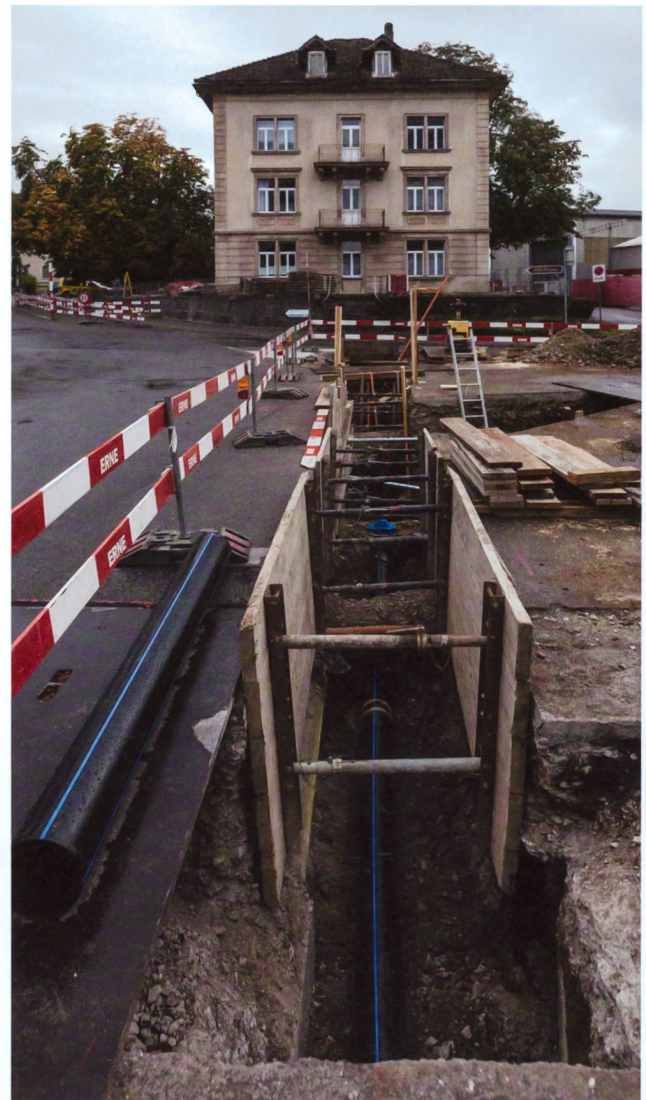
Abb. 17: Windisch-Klosterzelg 2017 (V.017.2). Blick von Osten mit dem Werkleitungsgraben an der Kreuzung Klosterzelg-/Industrie-/Reutenenstrasse. Zahlreiche alte Werkleitungen queren hier den verdolten Süssbach. Im Hintergrund das ehemalige Restaurant «Brunegg».
