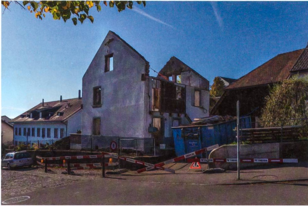
Abb. 26: Windisch-Ländestrasse 2017 (V.017.8). Blick von Nordosten auf Haus Ländestrasse 2 während der Abbrucharbeiten. Das benachbarte Haus Ländestrasse 4 weiter hangabwärts steht über einem grossen römischen Steinbau der Zivilsiedlung östlich des Legionslagers Vindonissa.
