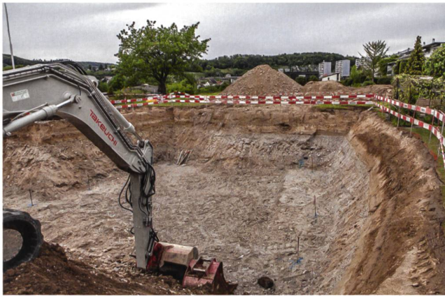
Abb. 18 Brugg-Badstrasse 2016 (Bru.016.2). Ansicht der ausgebaggerten Baugrube von Südosten mit der geologischen Schichtenabfolge in den Profilen. Weit im Hintergrund, zwischen Baum und Aushubdeponie, die Hausdächer von Brugg-Altenburg, Standort des spätrömischen Kastells.
