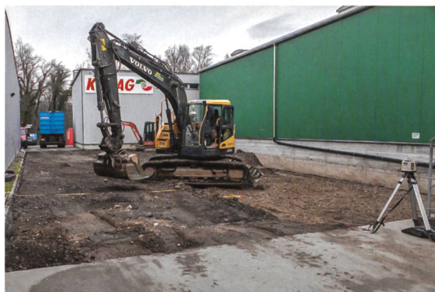
Abb. 17 Brugg-Wildischache 2016 (Bru.016.1). Industrie-Archäologie? Ansicht von Süden auf einen neuen Aushubbereich zwischen bestehenden Gewerbebauten. Unter dem abgebauten Teerbelag liegt eine moderne Kiesplanie, darunter folgt der sterile Aareschotter.
