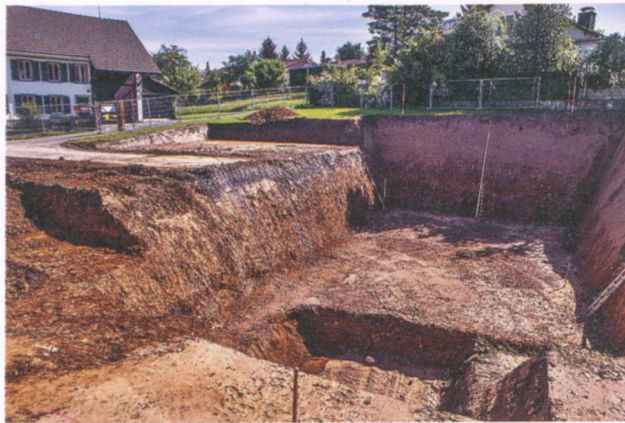
Abb. 5: Archäologisch negativ ist positiv für die Bauherrschaft: Beispiel einer natürlichen, quartärgeologischen Schichtabfolge ohne erkennbare Befunde in einer Baugrube in Hausen.
