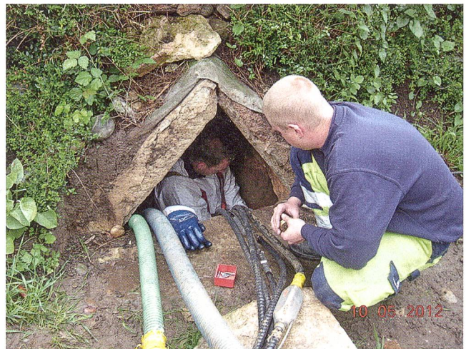
Abb. 11: Windisch-Dohlenzelgstrasse/Jurastrasse 2012 (V.012.3). Mitarbeiter der Kanalreinigungsfirma am und im «Schacht B» der römischen Wasserleitung mit seinem giebelförmigen Markierungsstein.
