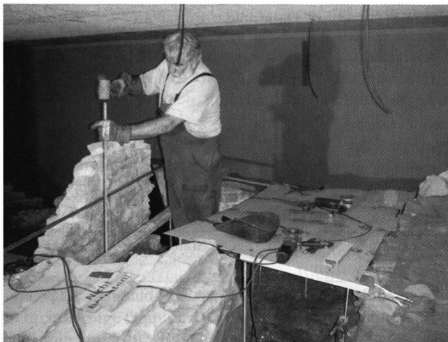
Abb. 2: Baustelle Offiziersküche. Für die Ausstellung wird der teilweise zerstörte Herd mit modernen Ergänzungen in seiner ehemaligen Grösse von fast 10 m 2 wieder sichtbar gemacht.
