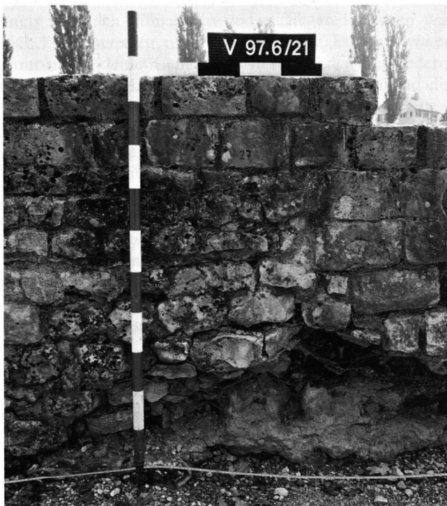
Abb. 14: Windisch-Amphitheater 1997 (V.97.6): Eine Schadenstelle am Mauerwerk des Arena-Umganges (vor dem Nordeingang im Inneren des Ganges).
