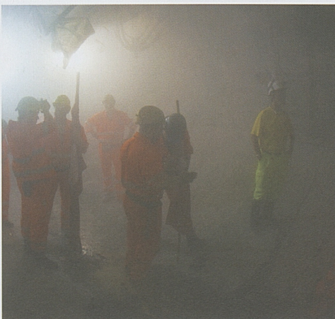
Kurz vor dem grossen Auftritt: Die Mineure warten gespannt unter der Tunnelbohrmaschine.
