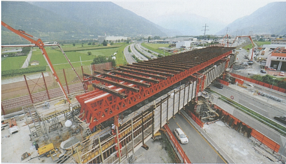
Nodo di Camorino: Die neue Eisenbahnbrücke über die Autobahn A2 wird betoniert.
